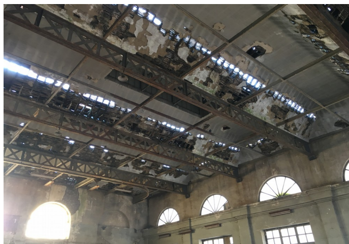
Figure 15 : Certaines toitures sont dans un état de délabrement avancé. Photo : Benjamin Boypa.
