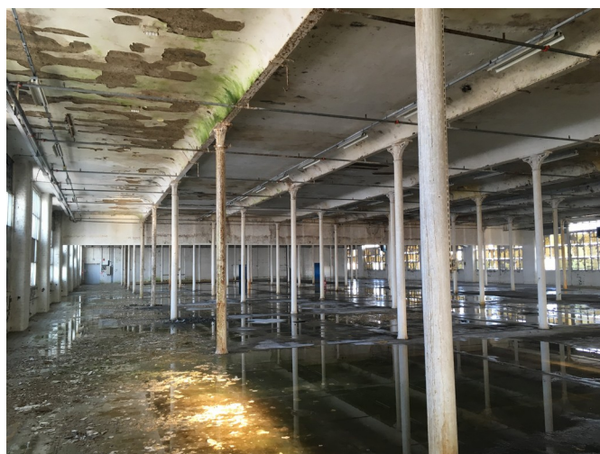
Figure 16: Les infiltrations présentes à tous les étages du bâtiment principal illustrent l'ampleur des travaux nécessaires. Photo : Benjamin Boypa.
